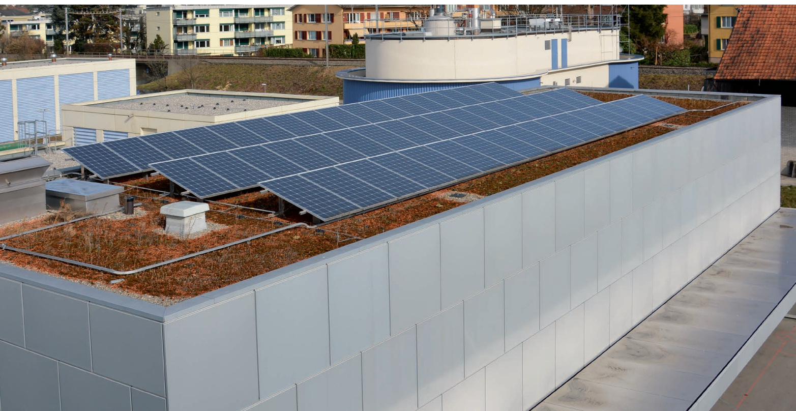
Solarstromanlage auf dem Dach des Lagergebäudes der Werke am Zürichsee AG
