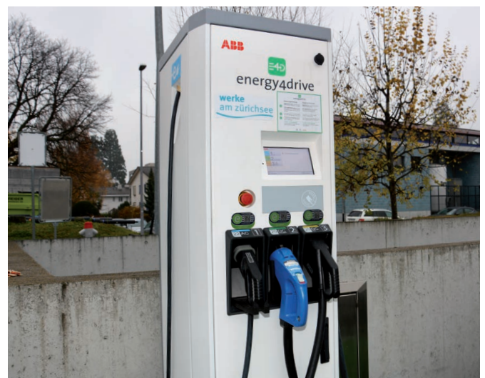
Öffentliche Schnellladestation bei der Werke am Zürichsee AG
